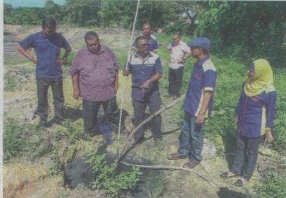
AZMAN (dua dari kanan) dan Kalithasan (tiga dari kanan) meninjau kawasan kebocoran paip saluran kumbahan yang mengakibatkan pencemaran kolam takungan banjir di Taman Desa Mewah, Semenyih, Kajang semalam.
